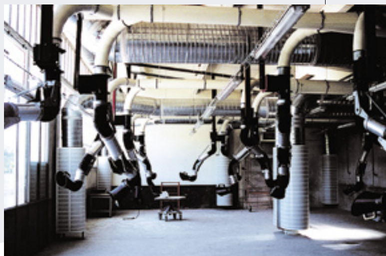
▲ Installation centralisée de captage à la source par bras d'aspiration
