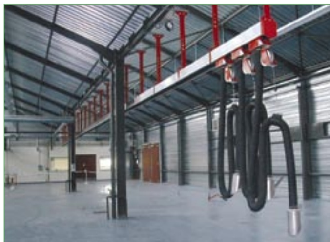
Installation d'équilibreur avec chariot coulissant sur rail.
